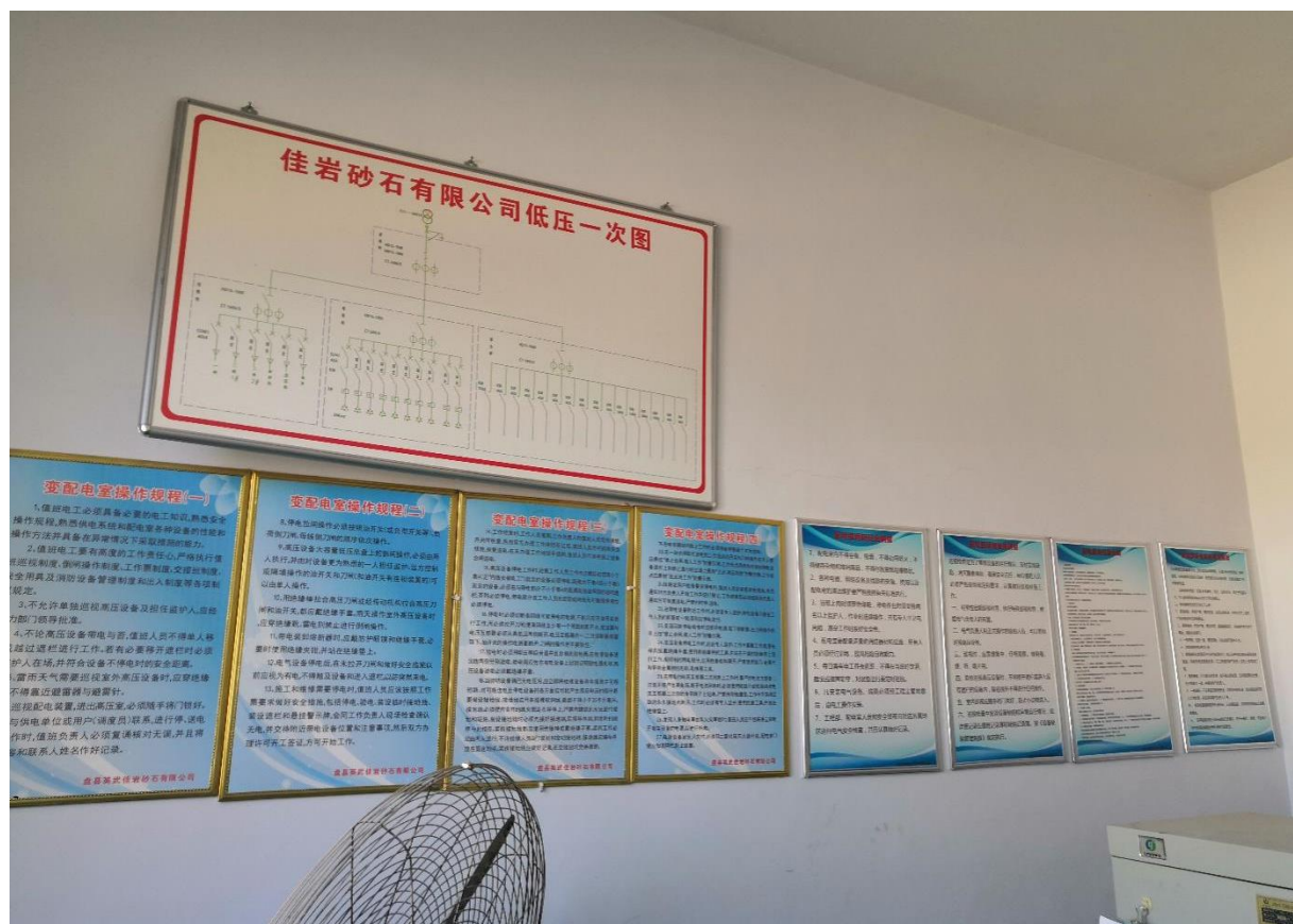
低压配电图上墙
