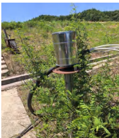
图15：初期坝顶GPS表面位移监测设施
