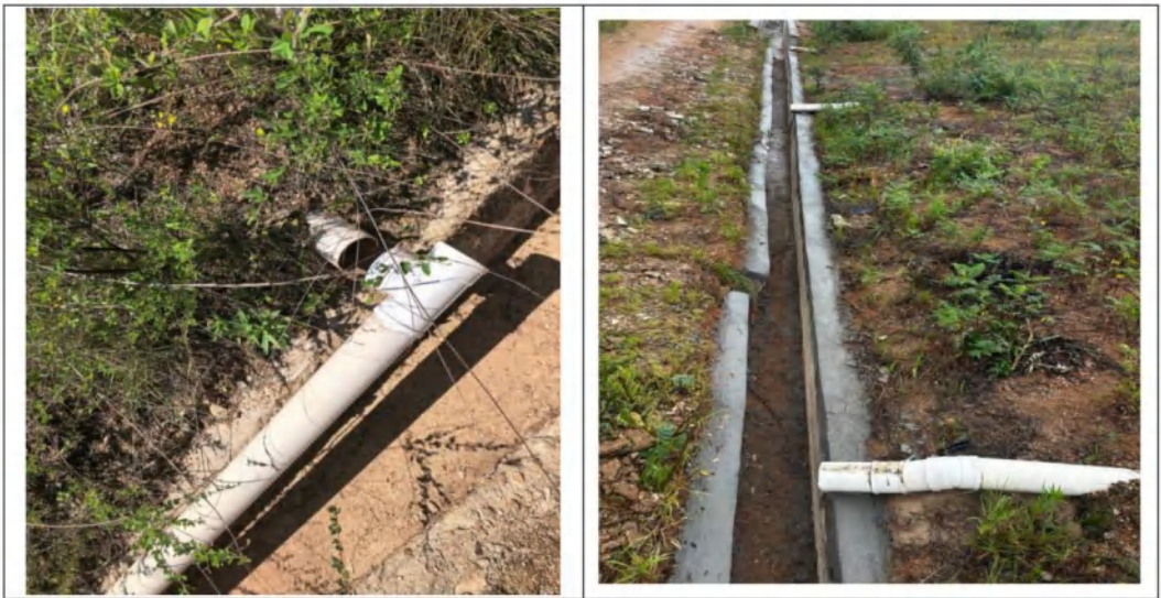
7、排水沟内多处放置建筑材料，应清理干净，部分区段内有滚落的大块石块，应清理。
