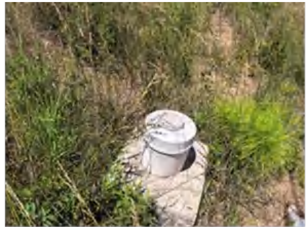
图14: 人工浸润线观测设施
