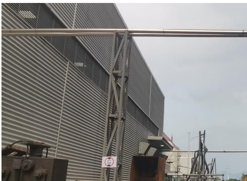
(4) 作业现场应急照明灯未通电
